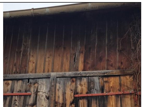
Abb. 3 Spalten in der Fassade Fl.St. 857/1
